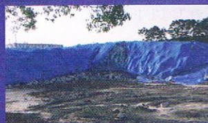
新松戸北中学校跡地に残されたガラ (7月8日現在) ※北小跡地も同様です
